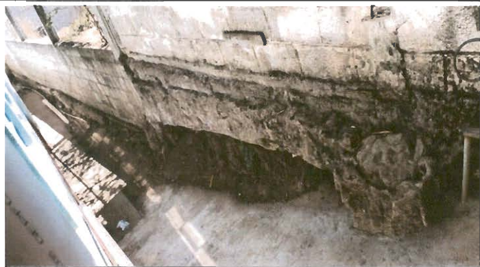
Foto 1: Los drenjes de la escuela están en mal estado.
