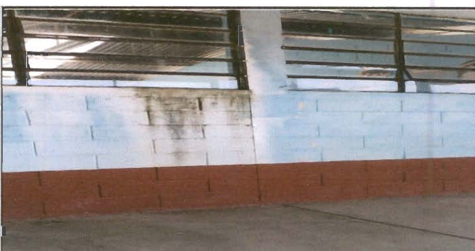
Foto 4: El techado del establecimiento, especialmente el del patio, debido a que las tejas están agujereadas, permiten la filtración del agua de lluvia
